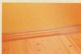
和室と廊下の段差
